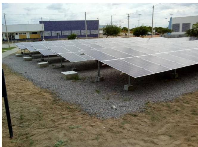
Fig. 7 Usina fotovoltaica da UFERSA Caraúbas.
