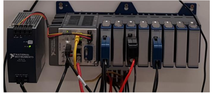
Fig. 1 NI cRIO-9039 em que o sistema de monitoramento é implementado
