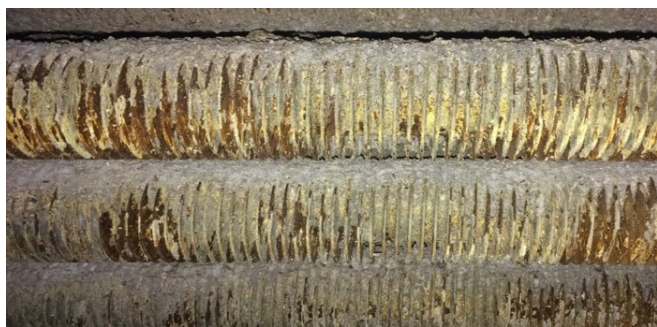
Fig. 4: Tubos aletados com incrustação.
